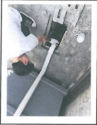
生活污水排放口
