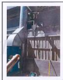
喷底漆、面漆、自然晾干、 漆磨工序废气排放口
